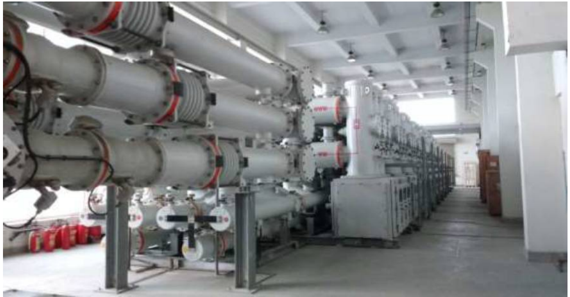
Fig 2.14 Actual Grounding of GIS
